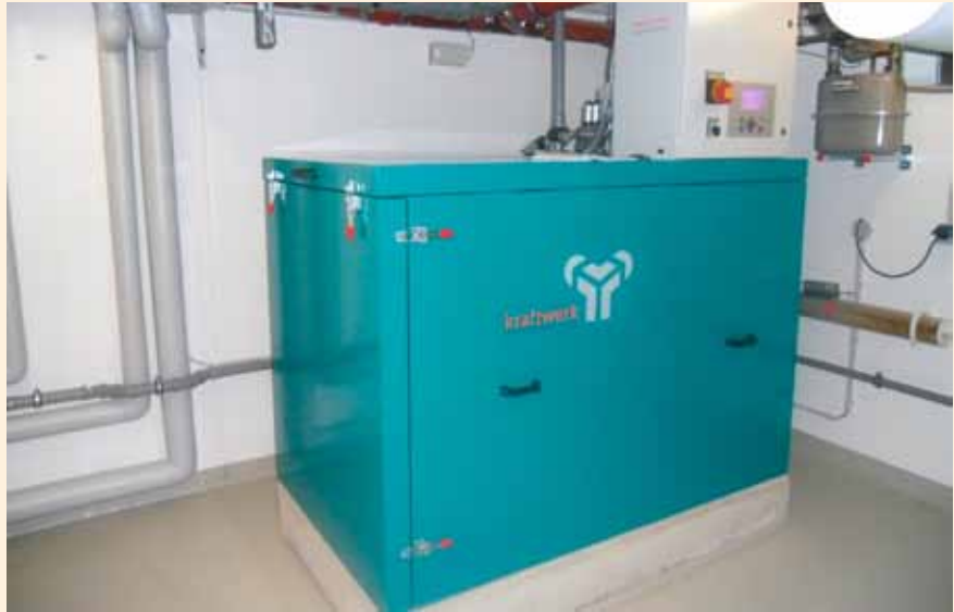
Im Programm der BALTICSOLAR-Tochter Constirling GmbH ist auch das Blockheizkraftwerk „Mephisto“
